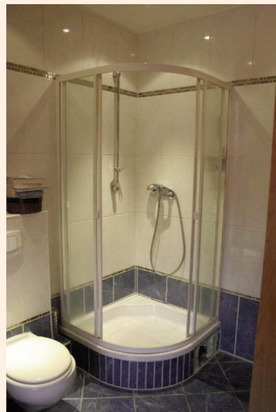
1 Die Dusche in einem häuslichen Bad. Oberflächlich gesehen, ist zunächst alles in Ordnung.
